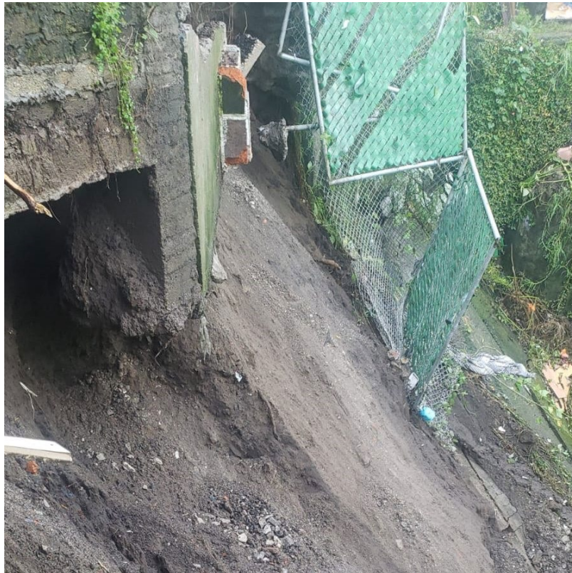
Figura 5. Afectaciones en la vivienda analizada
